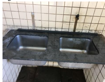
Figura 9: Pia do banheiro
