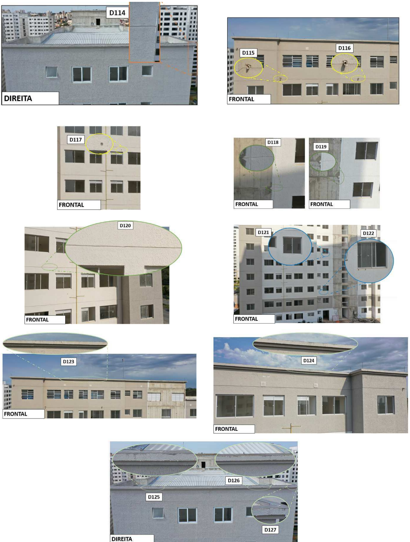
Figura A1 (Continuação) - Detalhes dos problemas/erros encontrado no edifício E1.
