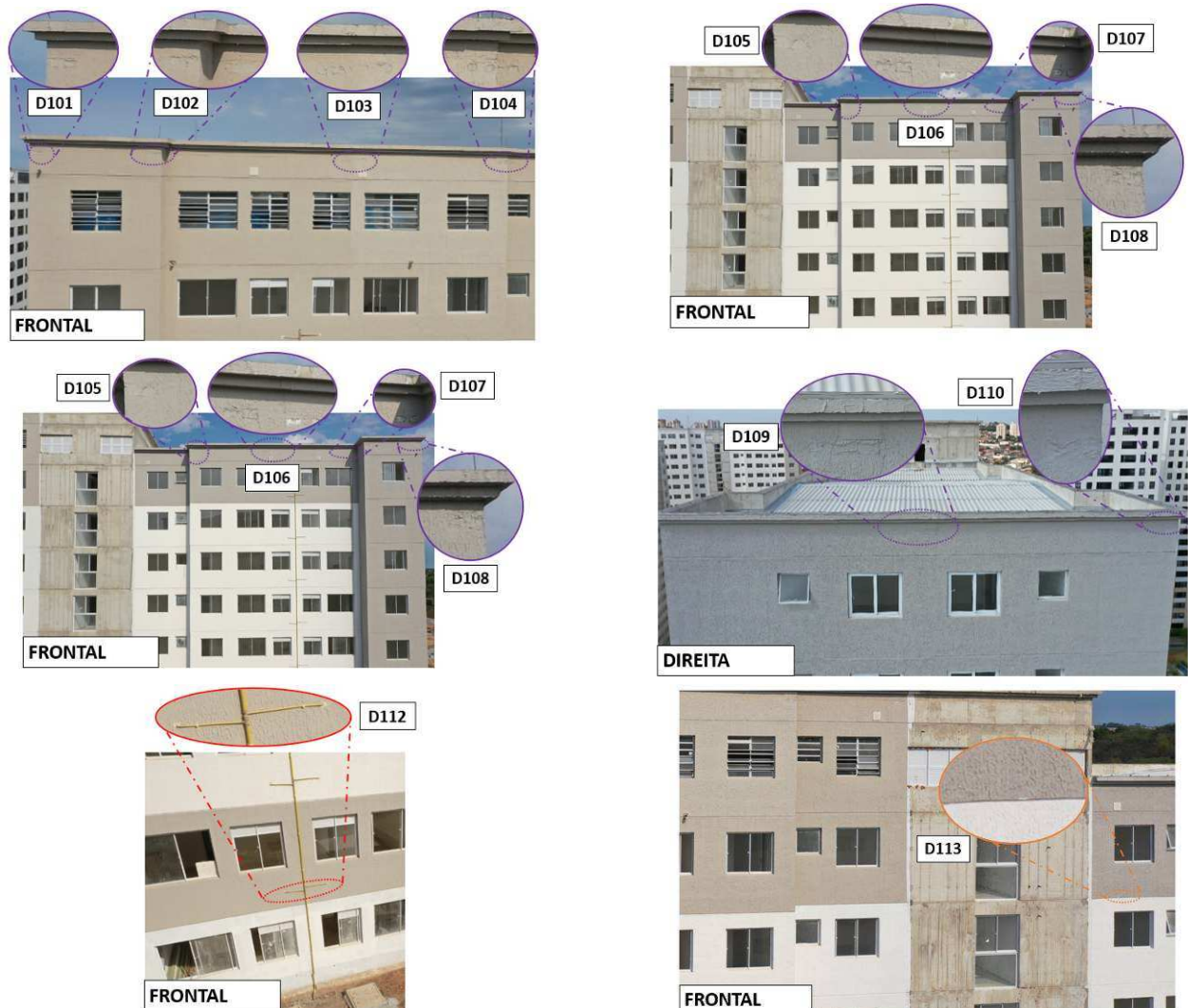
Figura A1 - Detalhes dos problemas/erros encontrados no edifício E1.
