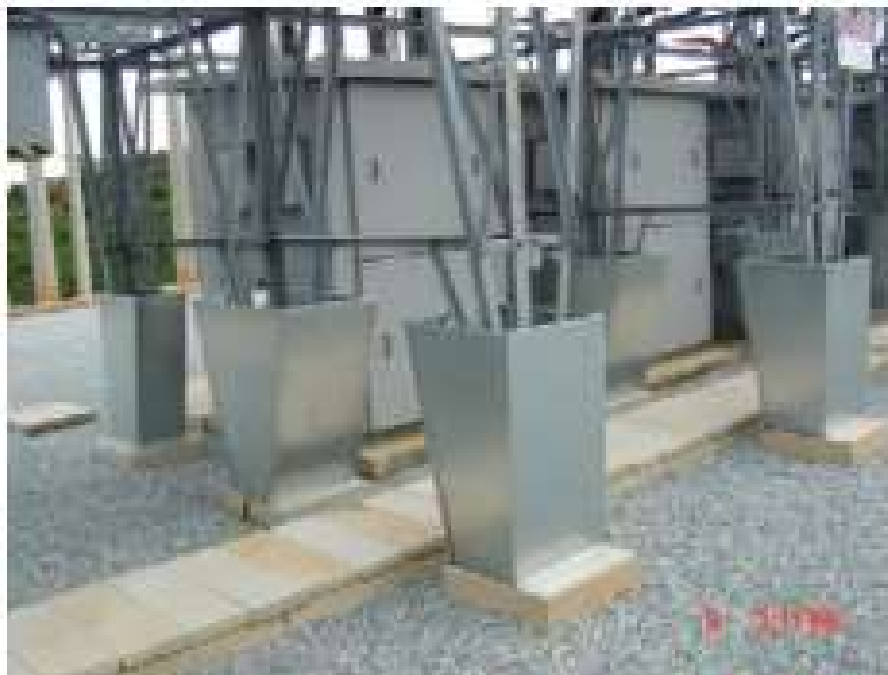
Figura 6 – Base das estruturas de 13,8KV com caixas metálicas contra animais
