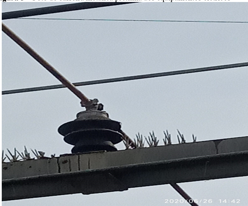
Figura 5 – Foto de barreira metálica próxima aos equipamentos elétricos
